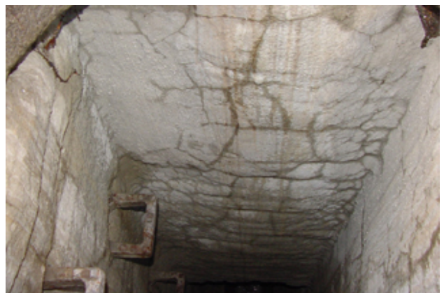
Schade aan een gerenoveerde rioolput
