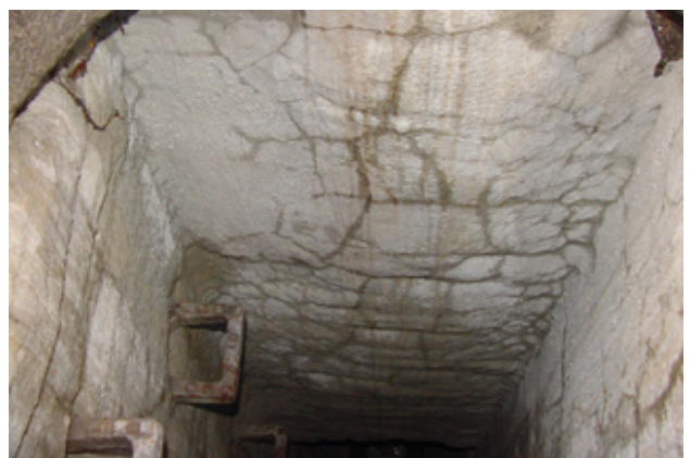
Schade aan een gerenoveerde rioolput
