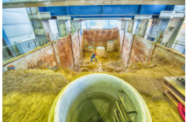
Inspectieputten in de 6 m diepe proefopstelling
